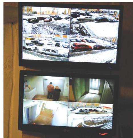
8 камер (5 вокруг дома и по одной на лестничном входе, входе в подъезд, на лифтовую площадку)
